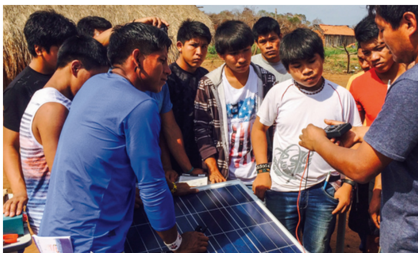
Foto de Instalação de placa fotovoltaica durante atividade do curso de energia solar na aldeia Piyulaga, do povo Wauja. Crédito: Letícia Leite.
