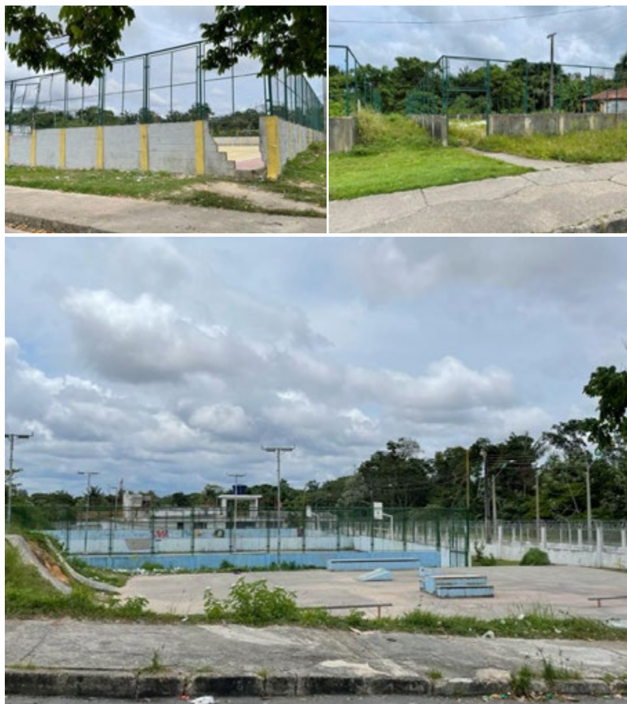
Figura 1 – Equipamentos públicos do Residencial Viver Melhor em situação de abandono
