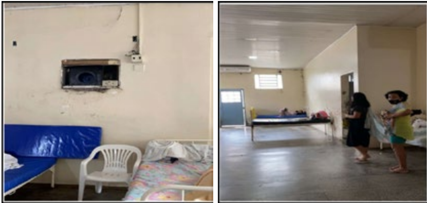
Imagem 12: Enfermaria feminina. Ambiente cheio de infiltrações. Climatização precária, banheiro em péssimas condições, sujo devido à insuficiência de RH e de falta de água. Banheiro imundo
