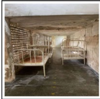
Imagem 27: Como o espaço é muito grande a manutenção é muito onerosa e difícil. O pouco que se faz não aparece
